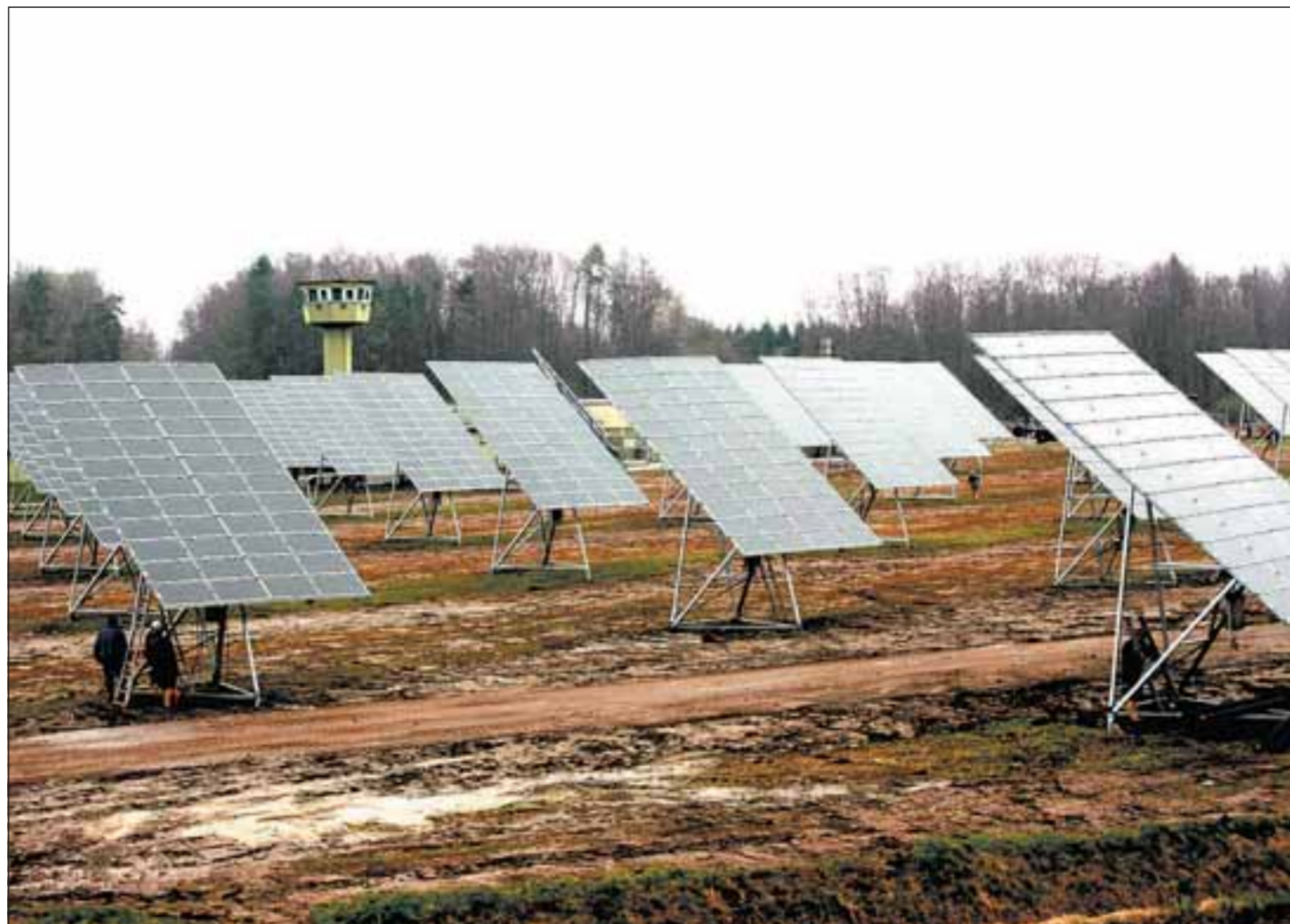
Im einstigen US-Hochsicherheitsbereich des Atomwaffenlagers Siegelsbach stehen insgesamt 120 Solarpanels mit einer maximalen Gesamtleistung von 417 Kilowatt. Die Jahresleistung reicht aus, um 150 Haushalte zu versorgen. Foto: Endres
